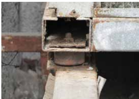
Figura 52. Conexión a la estructura de soporte de aire acondicionado
