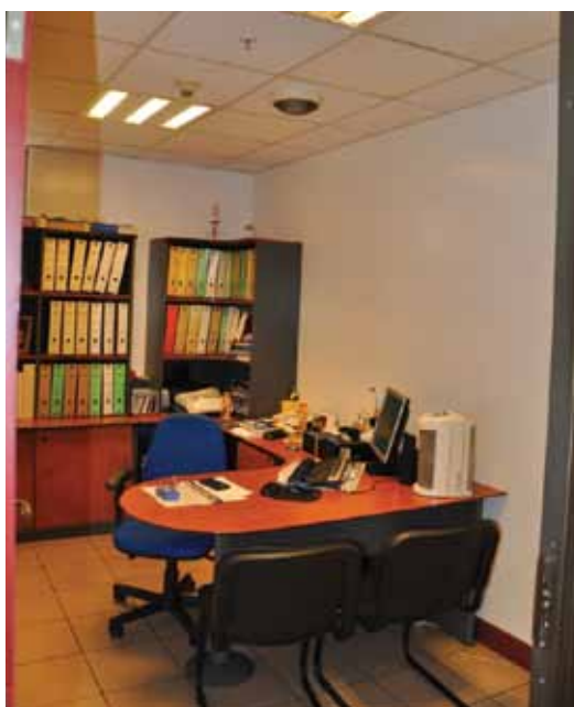
Figura 31. Equipo de comunicaciones sin anclaje
