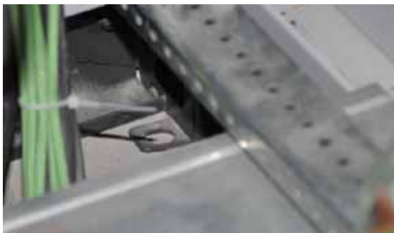
Figura 43. Ausencia de anclajes en equipo eléctrico
