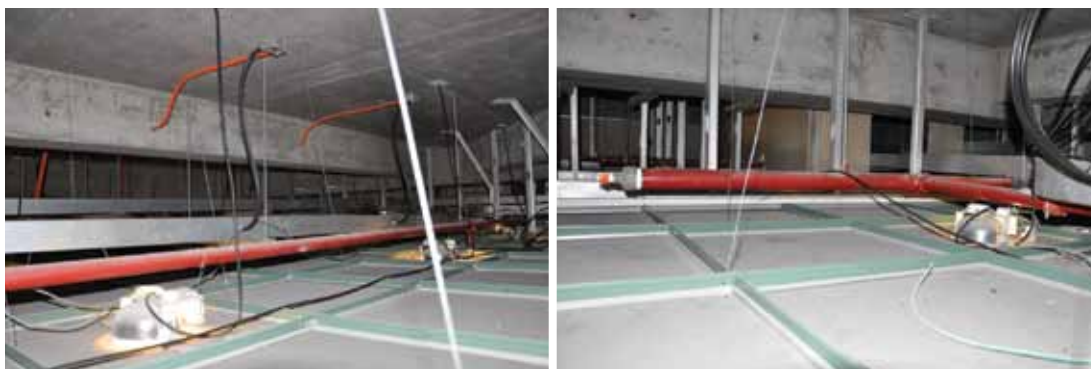
Figura 29. Red de incendio sin arriostres sísmicos
