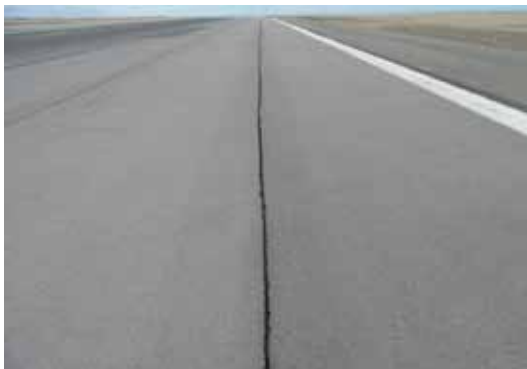
Figura 32. Pavimento pista de aterrizaje
