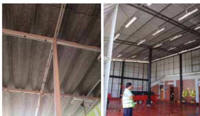
Figura 82 y 83. Ejemplos de vulnerabilidad sísmica estructura edificio S.E.I.
