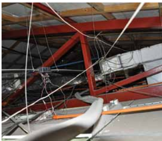
Figura 75. Ejemplos de vulnerabilidad sísmica cielos rasos
