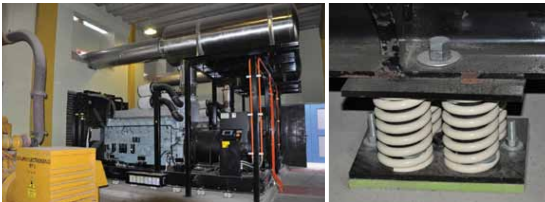
Figura 78. Ejemplos de vulnerabilidad sísmica equipos eléctricos y mecánicos
