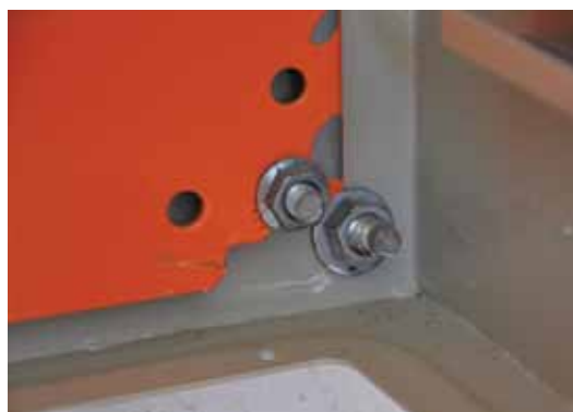
Figura 35. Gabinete eléctrico sala de impulsión con anclaje
