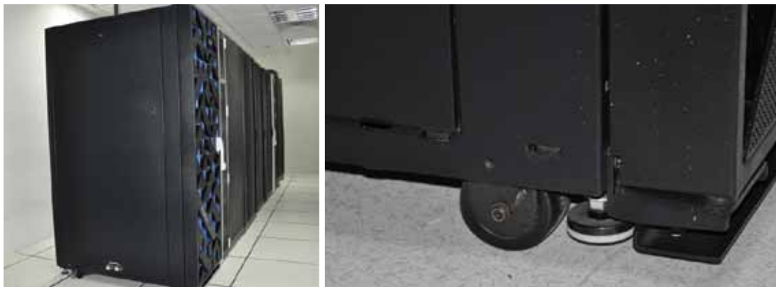
Figura 80. Ejemplos de vulnerabilidad Datacenter
