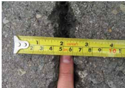
Figura 33. Grietas pavimento pista de aterrizaje
