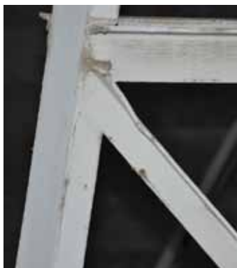
Figura 58. Daño en perfil de estructura de soporte correa transportadora
