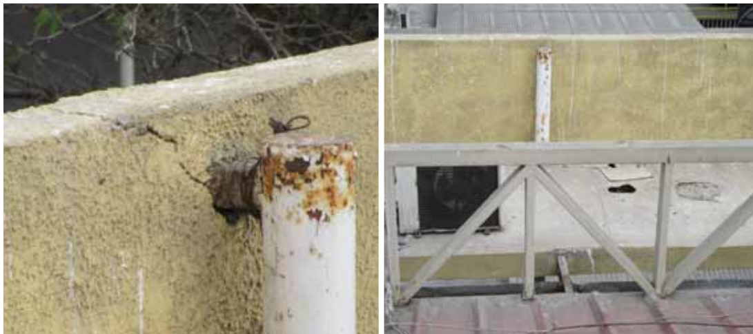
Figura 49. Daños de la fachada posterior
