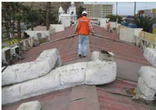
Figura 50. Equipos de aire acondicionado en techo
