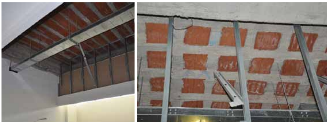
Figura 81. Ejemplos de vulnerabilidad losas de cielo
