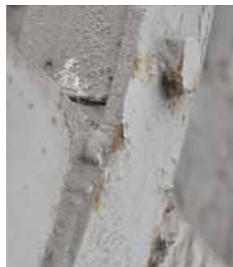
Figura 60. Fisura en perfil estructura de soporte correa transportadora
