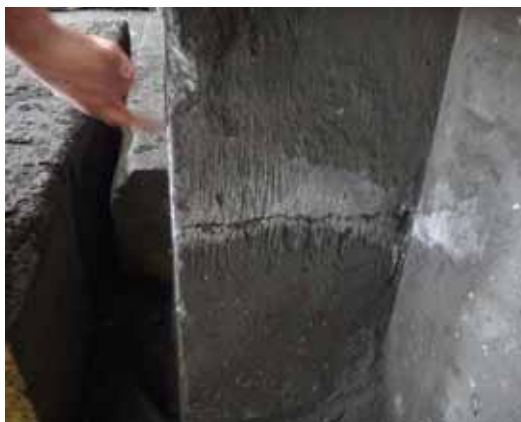
Figura 57. Daño en columna marco sismorresistente
