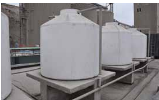
Figura 63. Estanques de agua potable en techo
