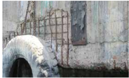
Figura 54. Estado del hormigón de losa
