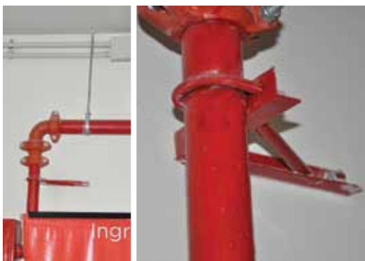
Figura 38. Anclajes de red de incendio
