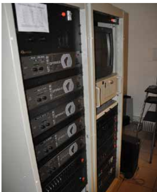
Figura 30. Archivadores sin protección sísmica
