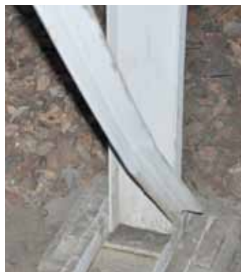
Figura 59. Daño en perfil de estructura de soporte correa transportadora
